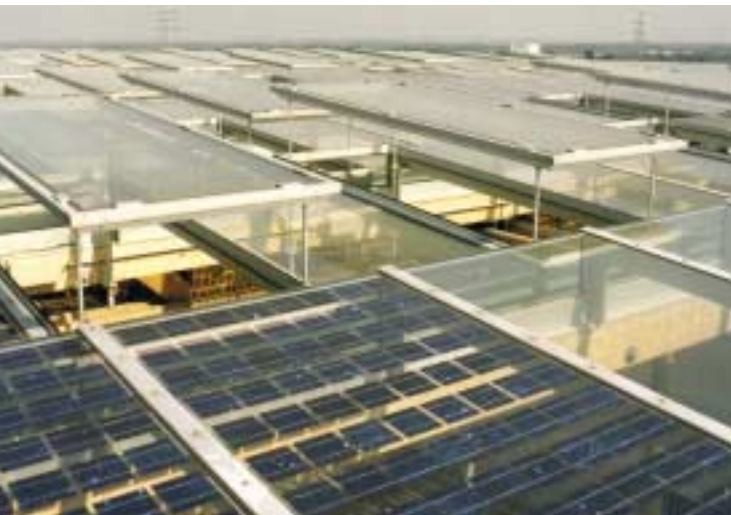
Dachintegrierte Fotovoltaikanlage auf der Fortbildungakademie Mont-Cenis in Herne
