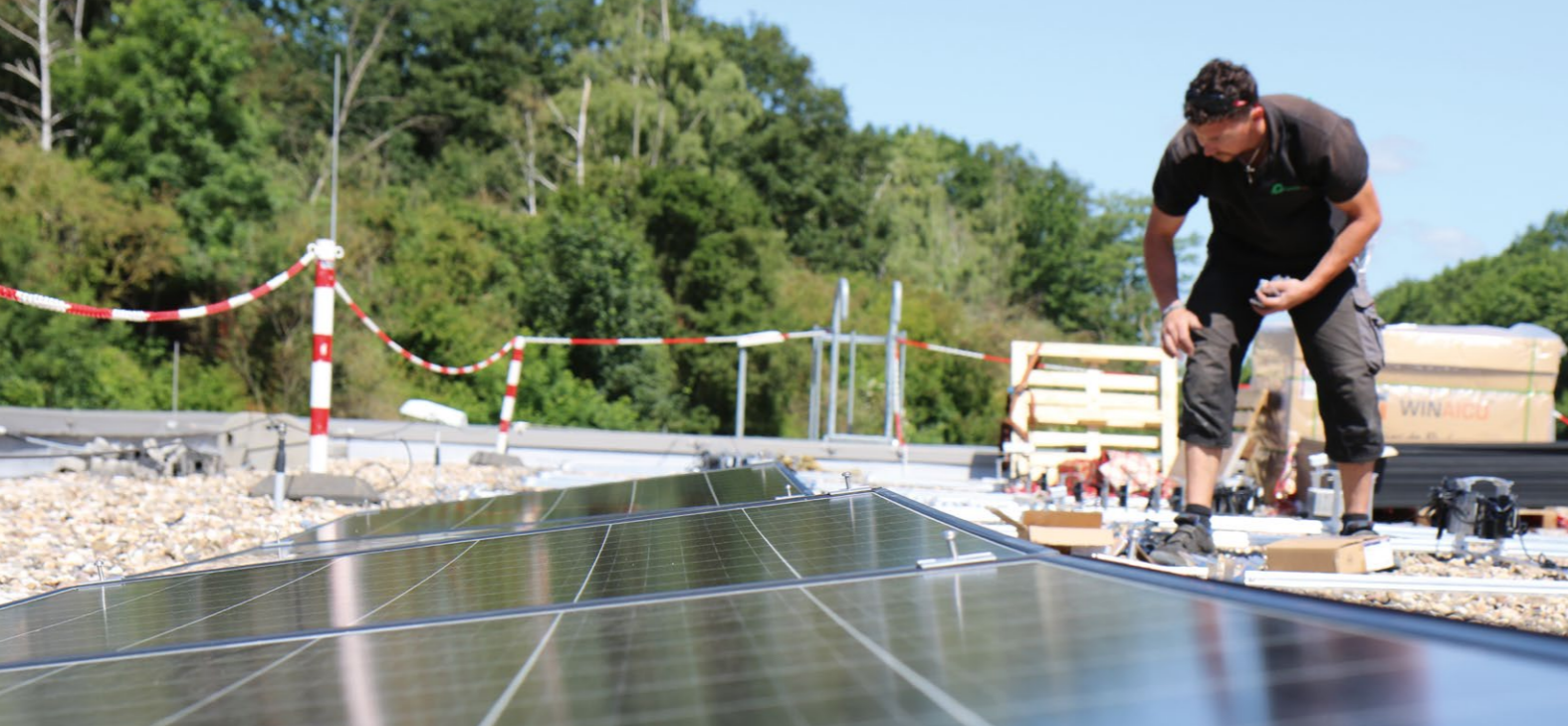
In zwei Arbeitstagen wurden auf dem Dach der Autobahnpolizeiwache in Rheydt 48 Photovoltaik-Module installiert.
