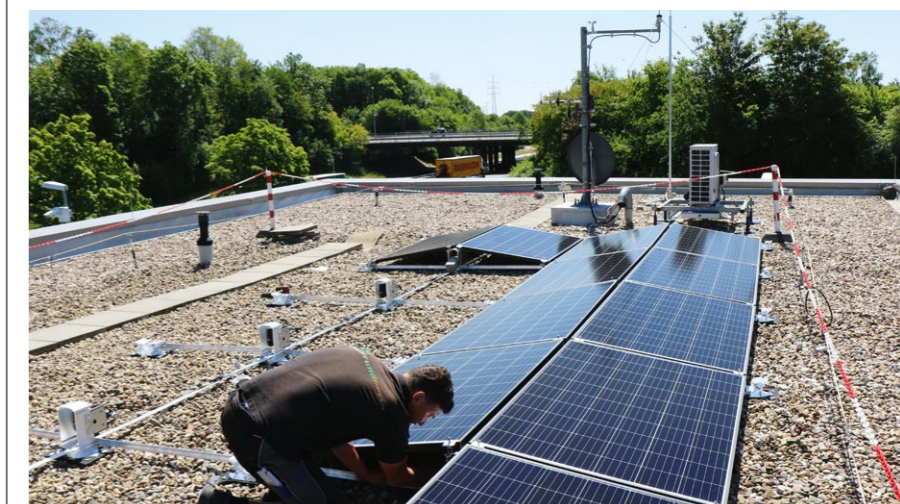
Auf dem Dach der Autobahnpolizeiwache wird jetzt Strom getankt.
