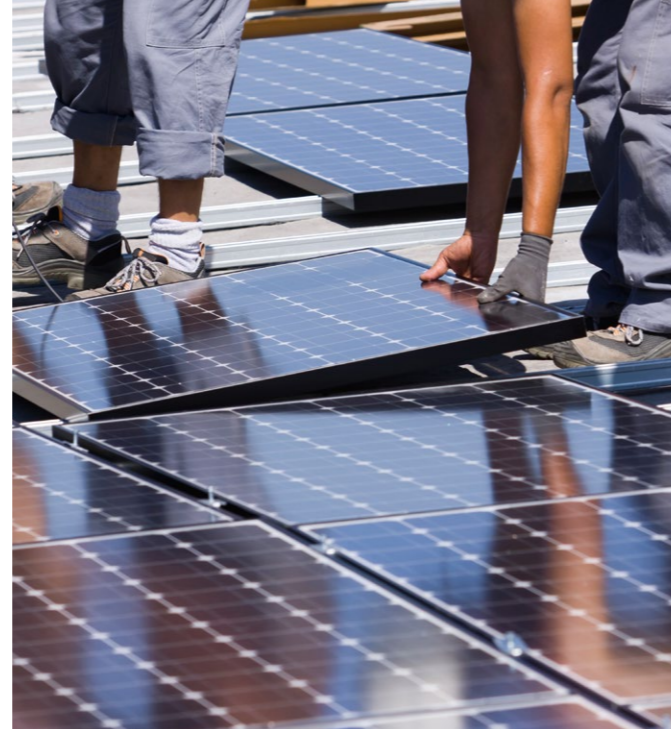
Im Rahmen einer Umweltoffensive der Landesregierung baut der BLB NRW die Zahl der Photovoltaik-Anlagen auf seinen Dächern deutlich aus.
