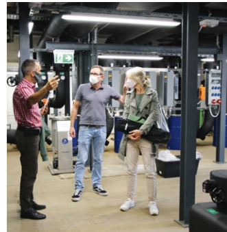
Auch die komplette Technikzentrale wurde auf den neuesten Stand gebracht.
